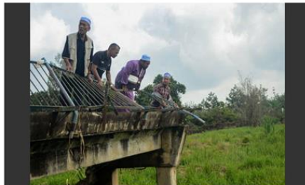
Penduduk menuju keatas jambatan yang runtuh selepas dihyndkan arus deras banjir pada 29 Nov lepas ketika tinggal di Rong Chendak, Pasir Mas, pada Selasa. - Gambar Bernama
